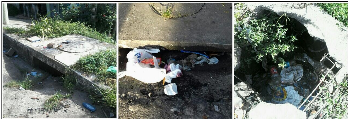
Figura 4 - Depósito de resíduos sólidos nos dispositivos de drenagem.
