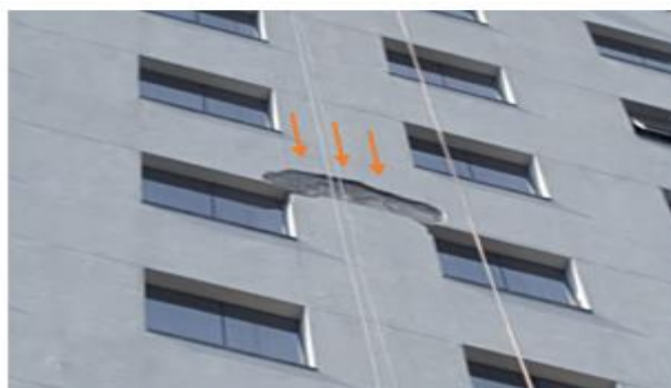
Figura 03: Patologia ocasionado na região do encunhamento na parte externa de edifício (Fonte: SANTOS, 2019)
