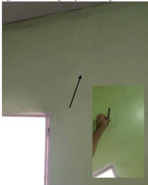
Figura 9. Fissura diagonal por sobrecarga na alvenaria
