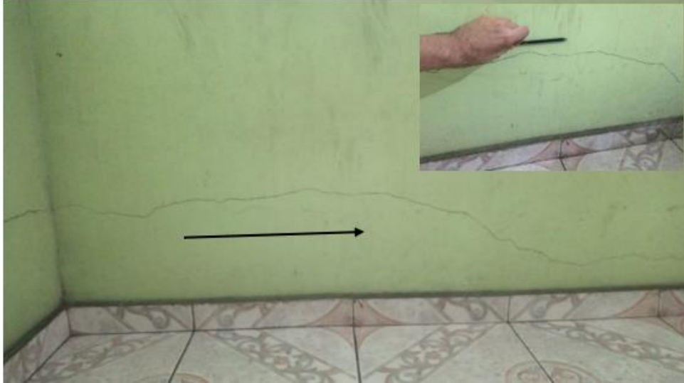
Figura 7. Fissura horizontal por movimentação térmica na alvenaria
